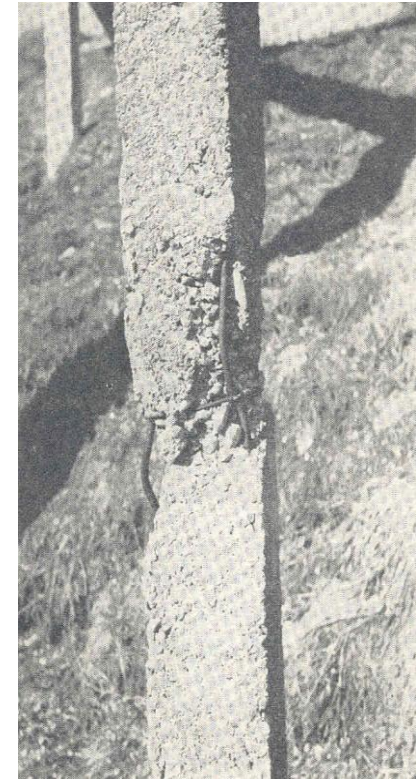
Rupture en compression d'un poteau survenue à un endroit faible (nid de cailloux)
